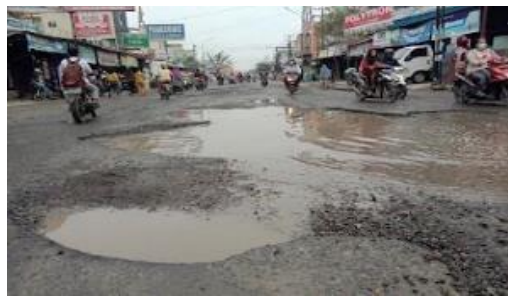
Gambar 1. Kondisi Kerusakan Jalan Marelان Raya (Sumber: metroindo, 2022)
