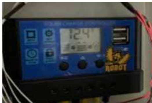
Gambar 9. Kondisi Pengisian Baterai
