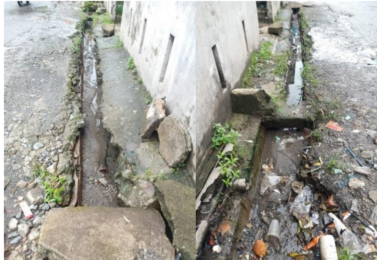
Gambar 3. Drainase yang rusak
