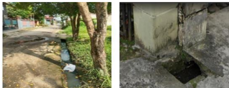
Gambar 8. Kondisi Drainase Lokasi Pemukiman
