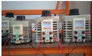
Gambar 9. Regulator voltage 220 volt
