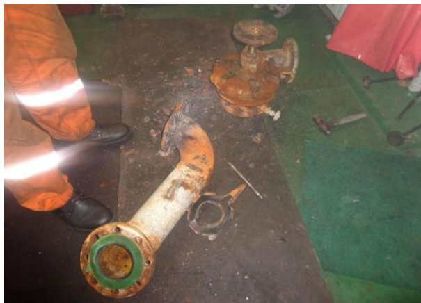
Gambar 11. Korosi Pipa Air Laut ( Sumber: Dokumen Peneliti)
