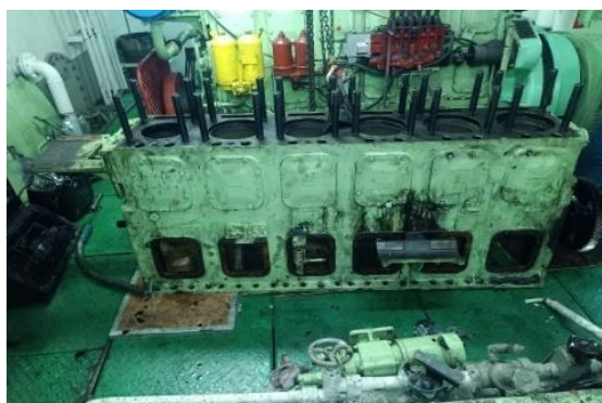
Gambar 4 Blok Mesin Diesel Generator (Sumber : Dokumen Peneliti)
