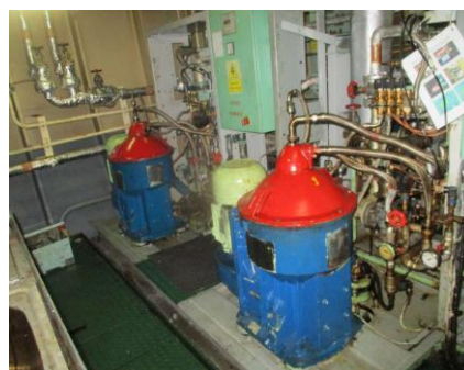
Gambar 6. Fuel Oil Purifier di MT Capella (Sumber: Data pribadi di kapal MT Capella)
