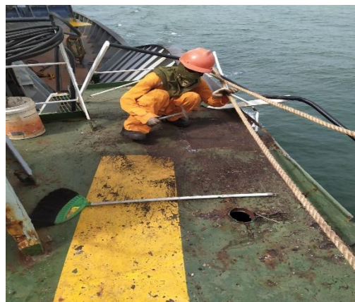
Gambar 4. Tindakan setelah terlepasnya Marine Panama Chock
