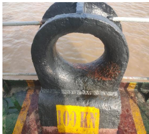
Gambar 1. Marine Panama Chock sudah terpasang
