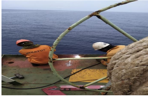
Gambar 5. Tindakan setelah terlepasnya Marine Panama Chock
