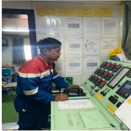
Gambar 5. Monitoring dan Controlling pressure cargo tank di CCR Sumber : Dokumentasi pribadi, 2023
