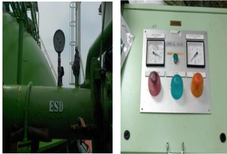
Gambar 4. Pengecekan ESD di Deck dan ESD di CCR
