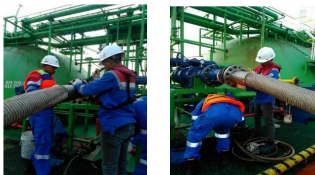
Gambar 3. Pemasangan Cargo Hose Liquid pada Manifold
