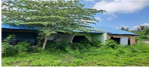
Gambar 3 Rumah yang rusak akibat bencana banjir
