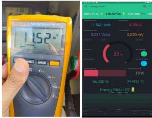
Gambar 10. Perbandingan Pengukuran Tegangan DC
