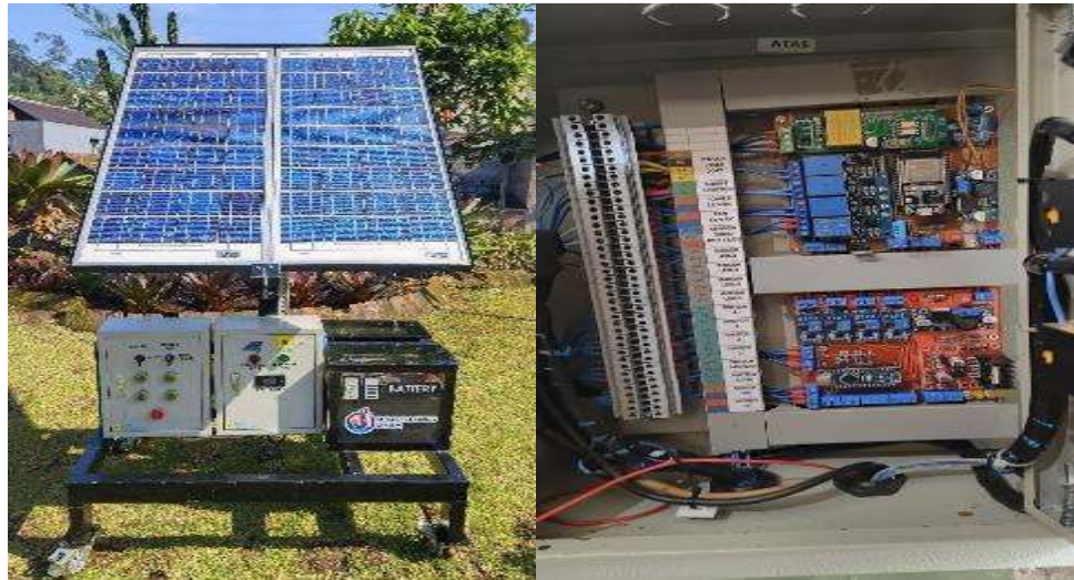
Gambar 2. Alat PLTS dan box Panel Sistem Monitoring.
