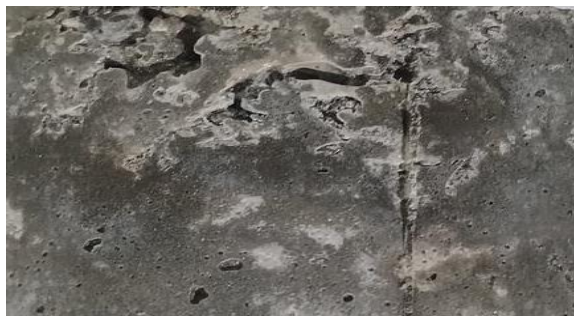
Gambar 5. retakan beton setelah perendaman selama 7 Hari
