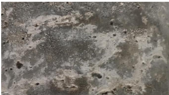
Gambar 6. retakan beton setelah perendaman selama 14 Hari
