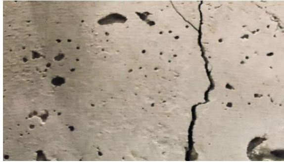
Gambar 4. retakan beton sebelum pengujian self-healing concrete
