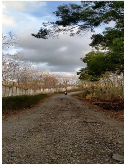
Gambar 2 Jalan Menuju Pantai Grajagan yang rusak
