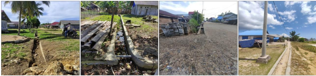
Gambar 1. Kondisi Permasalahan Jaringan Drainase di Kab. Konawe Kepulauan Sumber: Dinas Pekerjaan Umum dan Tata Ruang Kab. Konawe Kepulauan (2023)
