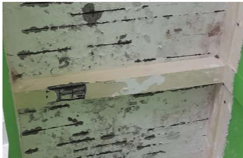
Gambar 3. Kerusakan struktur balok Mesjid Nurul Iman RSUP H Adam Malik
