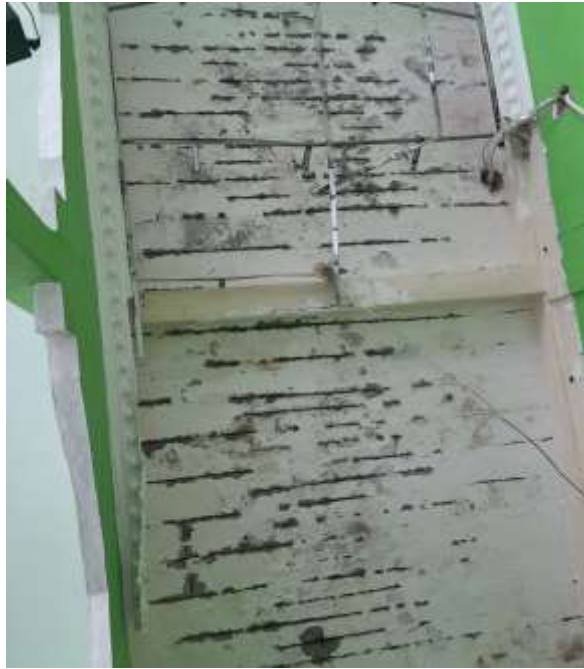
Gambar 2. Kerusakan struktur plat dak atap Mesjid Nurul Iman RSUP H Adam Malik
