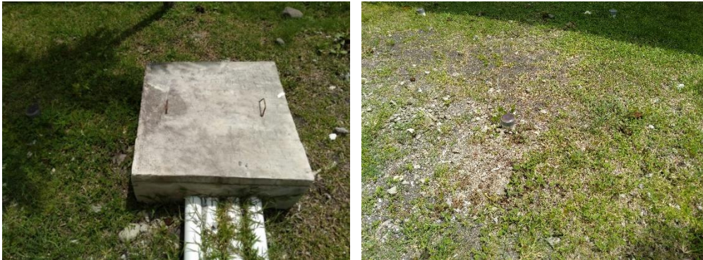
Gambar 3. (Kiri) Raw Water Tank; (Kanan) Sumur Resapan Air Hujan
